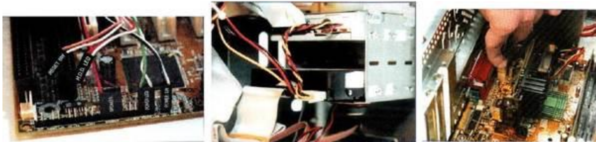
Рисунок 10 Подключение кнопок и светодиодов передней панели корпуса, соединение установленного оборудования, подключение питающих кабелей.
